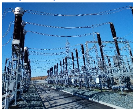
ПС 220 кВ Кировская (ОРУ-110 кВ)
