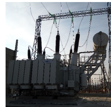
ПС 220 кВ Садовая (АТ-3)
